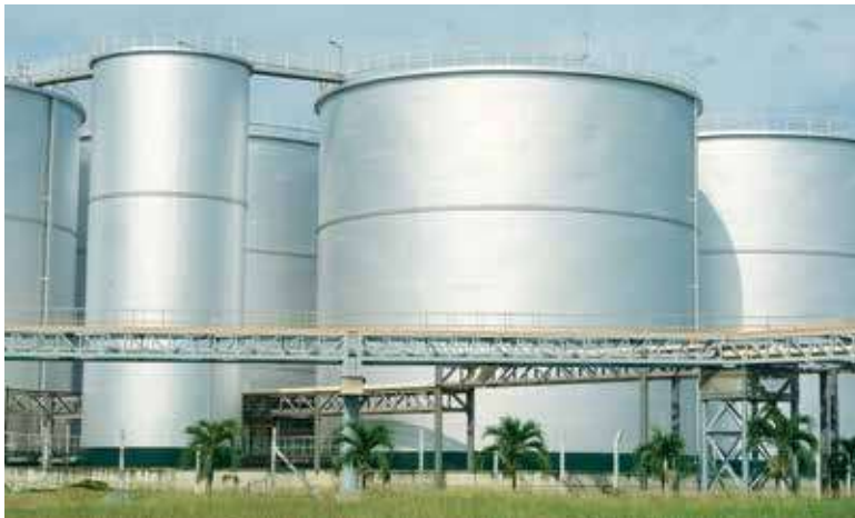
Für eine Tankfarm in Indonesien suchte DNR nach einer zukunftsfähigen Lösung auf Basis einer integrierten Architektur. Das Gateway pnGate PA ist dabei ein wichtiger Baustein.
