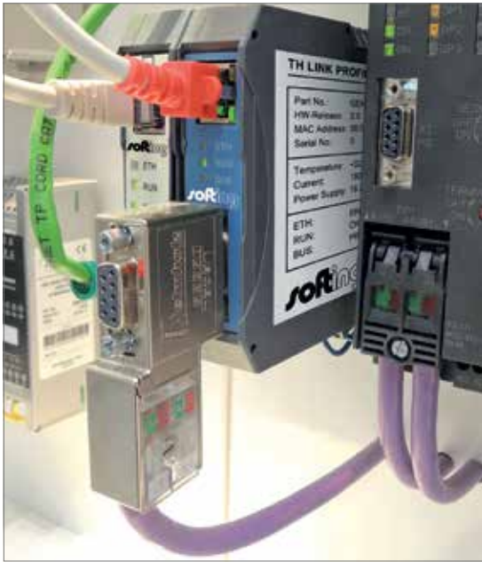
Das Gateway gibt bei der Implementierung ins Profibus-Netz detaillierte Tipps zur richtigen Konfiguration.
