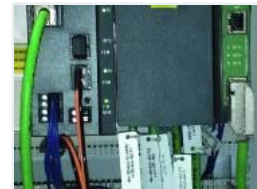
TH Link Profinet liefert auch bei wenig Platz im Schaltschrank detaillierte Information über die eingesetzten Geräte. (Bild: Audi)
